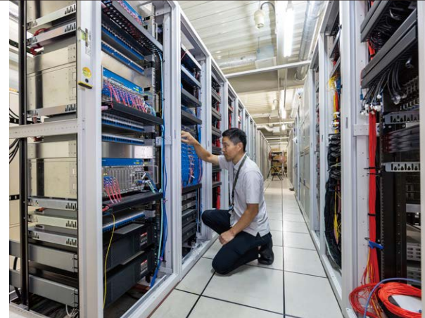
サーバー室のセキュリティや災害対策も万全
